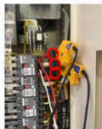
エスカレーター2号機計測中
