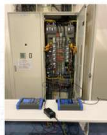
動力分電盤内
