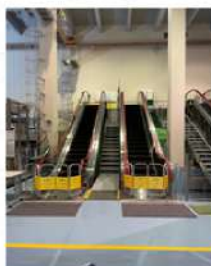
エスカレーター3号機2号機
